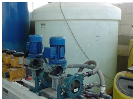
Sistema de dosificació de calç.
