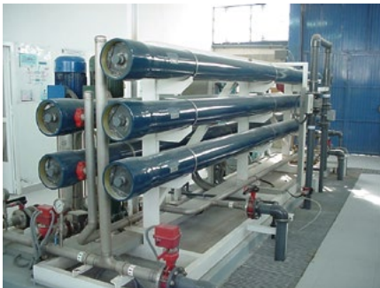
Bombes d'alta pressió i mòduls d'osmosi inversa. Foto: M. F. Chillón.
