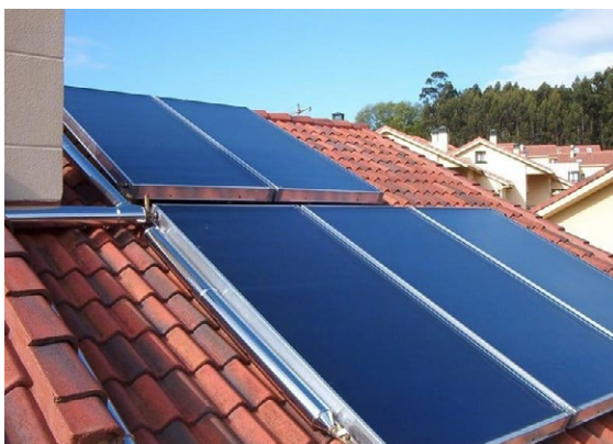
Instal·lació ACS en un habitatge unifamiliar. Foto: Renovablesverdes.com .
