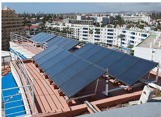
Instal·lació ACS en un hotel de Gran Canària. Foto: Aguiaringenieros.com.
