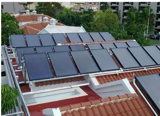
Instal·lació ACS en un edifici a Santa Cruz de Tenerife. Foto: Habitissimo.com .
