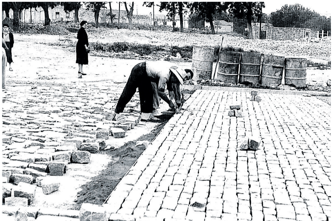
Colocación de adoquines por obreros especialistas de La Nucia. Fuente: Miguel Guardiola Fuster.
